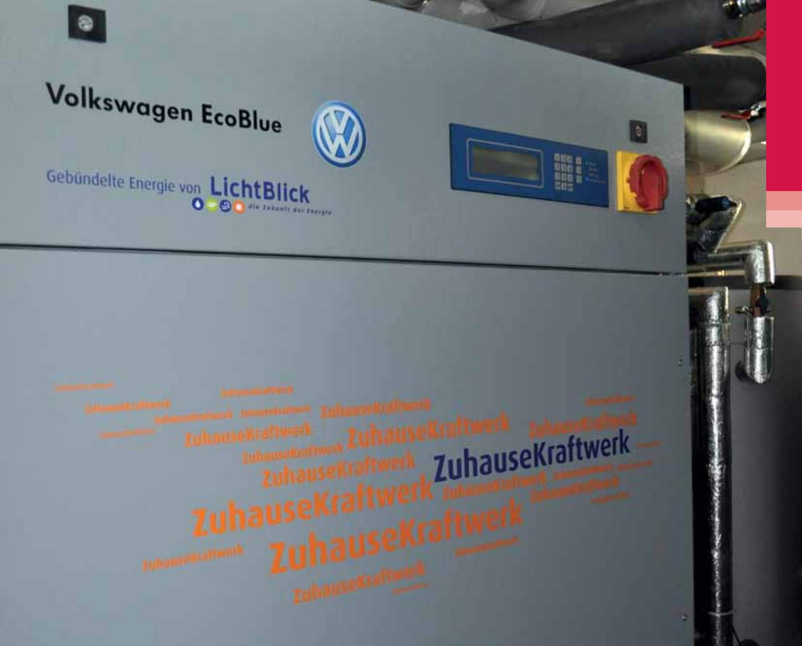
Umweltfreundliche und innovative Gasheizung – das ZuhauseKraftwerk von Lichtblick im Keller der Herzog-Ernst-August Straße
