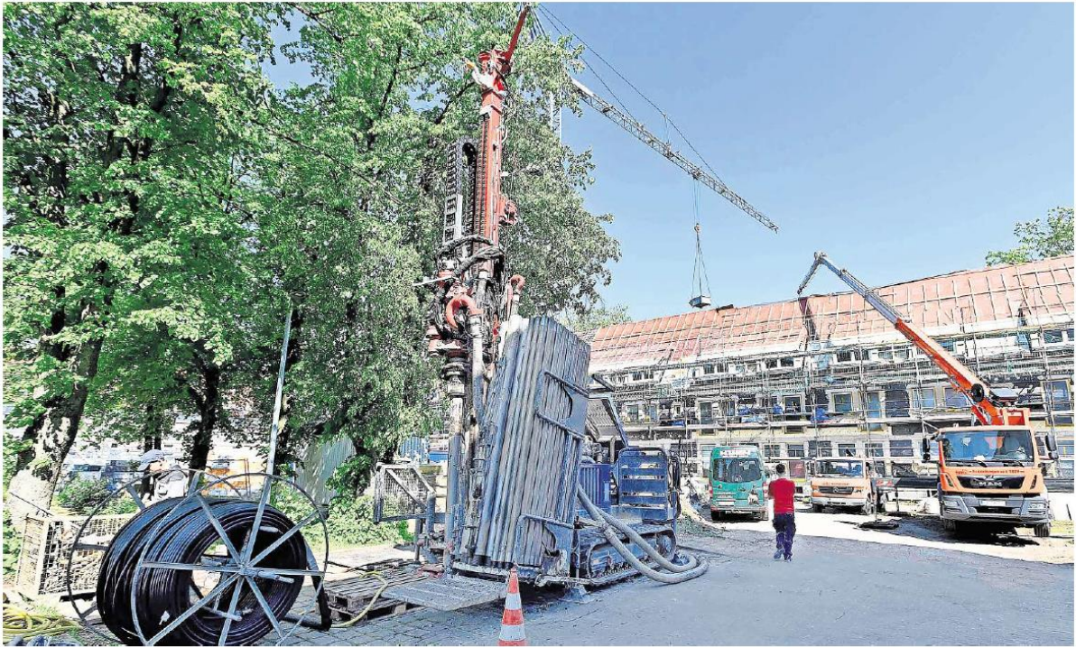
Probebohrung in Gifhorn: Die GWG will am Herbert-Trautmann-Platz künftig Erdwärme für die Energieversorgung nutzen.
