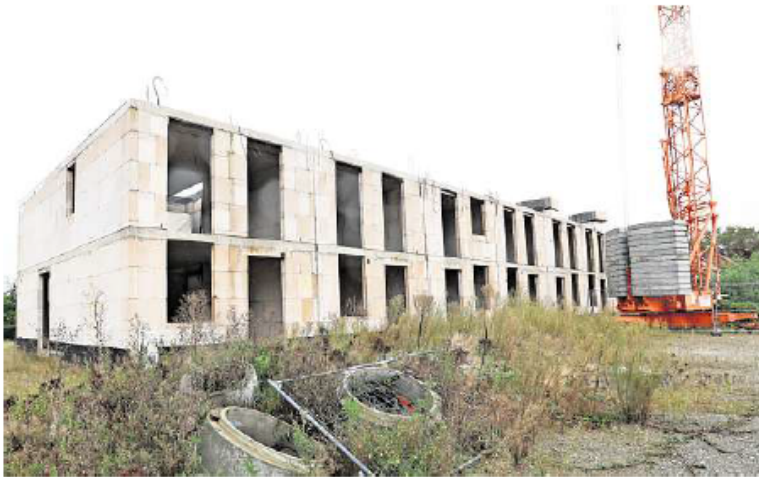
Rohbau ruine in Gifhorn: Der Investor dieses Mehrfamilienhaus-Projektes im Gebiet Hohes Feld ist pleite, die Baustelle ruht seit rund einem Jahr.
