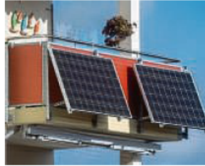
Solarmodule für ein Balkonkraftwerk hängen an einem Balkon.
