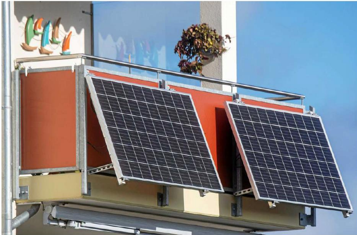
Sonnenkollektoren sind an einem Balkon installiert.
